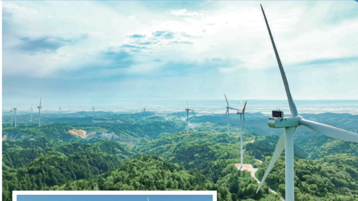
中里風力発電所（青森県） 36.0MW
