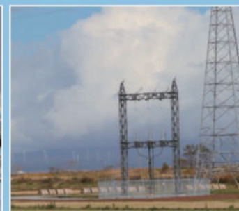
高電圧施設と中里風力発電所
