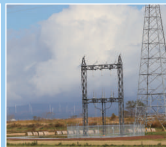
高電圧施設と中里風力発電所
